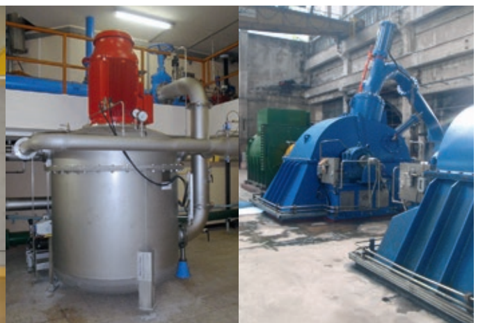
Turbine de Haute-Pierre (CH) à contre-pression intégrée à un réseau d'eau potable (Q = 0.083 m 3 /s, Hn = 104 m, Dext = 654 mm, 765 t/min, Pm = 76 kW)
