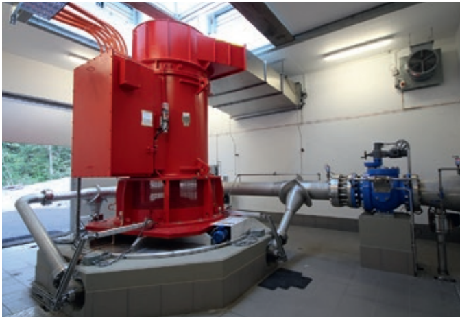
Turbine d'Icogne (CH) à 4 injecteurs, exploitant un réseau d'irrigation (Q = 0.473 m 3 /s, Hn = 479 m, Dext= 1018 mm, 1000 t/min, Pm = 1996 kW)
