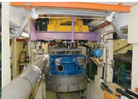
Turbine Pelton sur le stand d'essais en 2015
