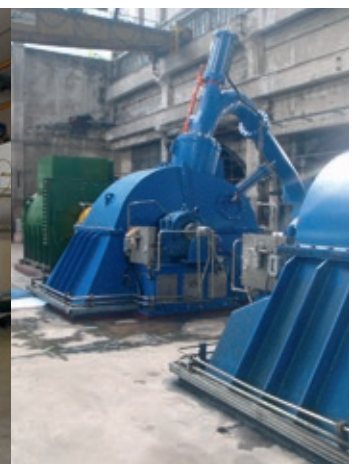
Turbine de La Gorge (France) à axe horizontal à 2 injecteurs, (Q = 0.900 m 3 /s, Hn = 440 m, Dext = 1120 mm, 1000 t/min, Pm = 3487 kW)
